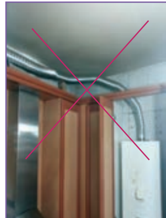
ح - هرگز از لوله های خرطومی به جای لوله رابط دودکش استفاده نکنید.
